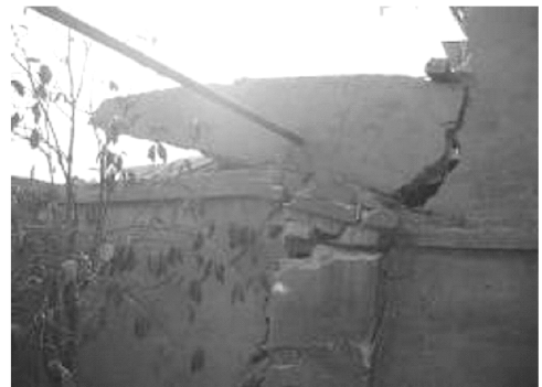
图 3 建筑物开裂情况
