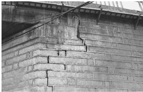
图1 加固前桥台裂缝图
