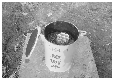
图 9 建好的多通道管监测井井口
