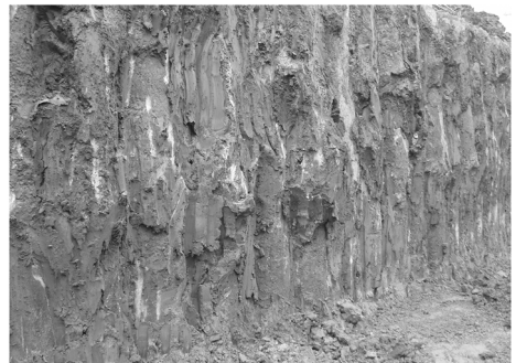
图 4 咬合桩断桩现象照片
