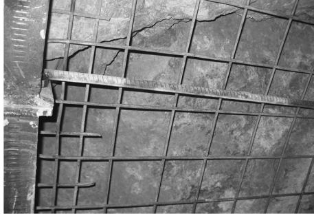
图 1 不良地质洞段围岩塌方情况
