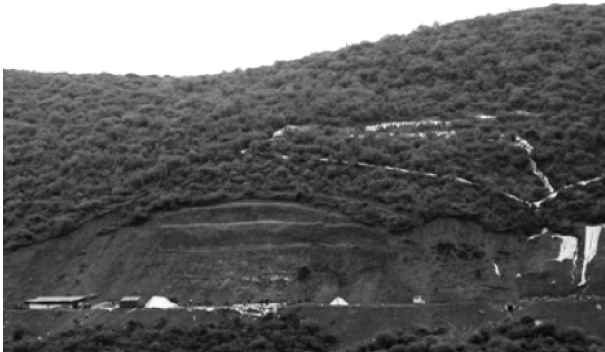
图1 国道 213 线 K193+060 滑坡全貌 (图中边坡面上的白色线为裂缝的分布状态)
