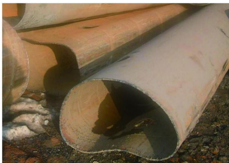
图1 工程施工中被挤损的套管
