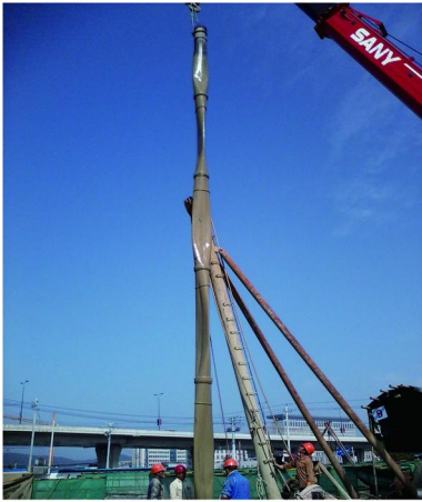
图 4 导管瘪管照片 2
