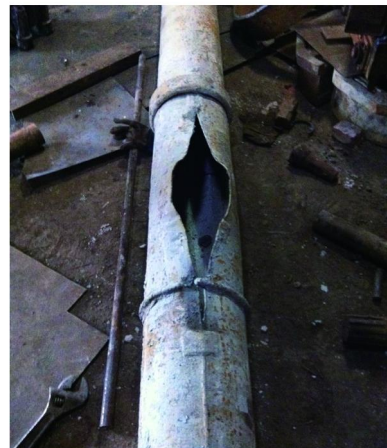
图 1 导管爆管照片
