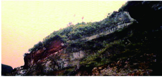
图 1 K93 + 600 顺层岩石滑坡坡前部
