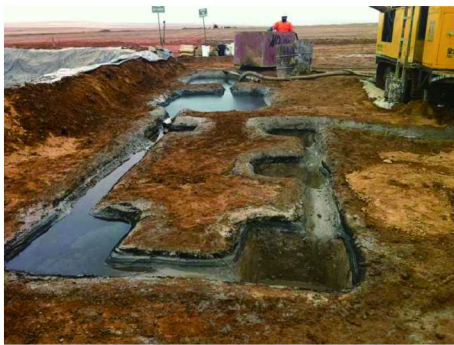
图4 泥浆槽净化系统
