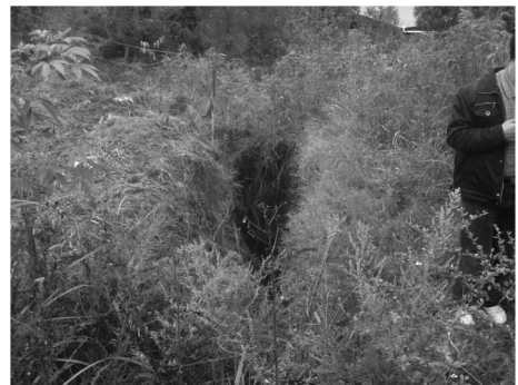
图3 滑体顶部的裂缝
