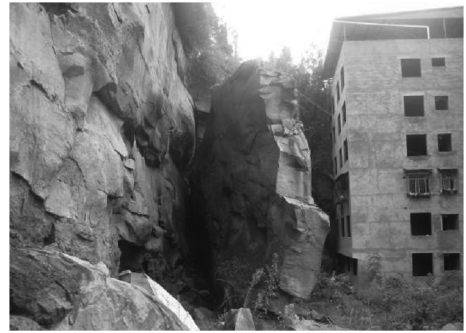
(a) 危岩3脱离了母岩坐落在地面上
