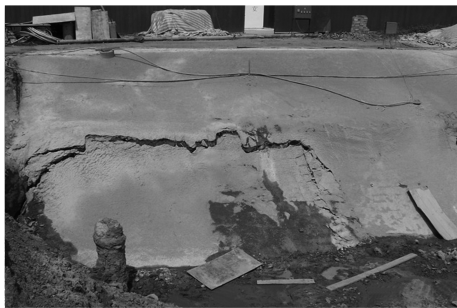
图4 止水帷幕渗漏水引发的坍塌
