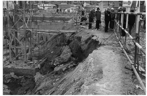
图5 坡面土体被破坏而发生的坍塌
