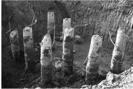
图3 降水不到位而引起的溜坡
