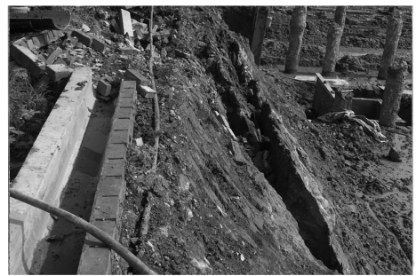
图6 坡面土体为新近回填土而发生的坍塌
