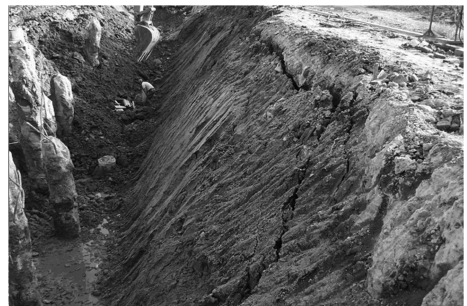
图2 护坡措施不及时而发生的溜坡
