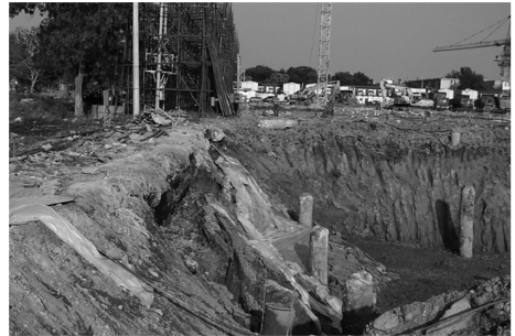
图1 开挖因坡度系数小发生垮塌的情况
