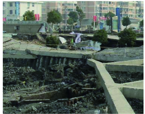
图3 基坑垮塌现场照片
