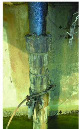
图 3 套管伸缩器实体应用照片
