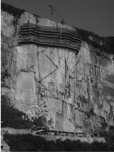
图1 锚索栈桥照片
