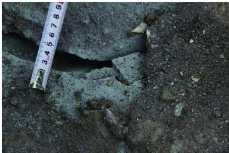
图 4 裂缝最大宽度
