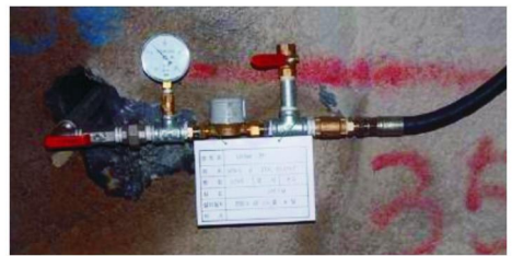
图3 水幕巷道中的水平水幕孔供水状态
