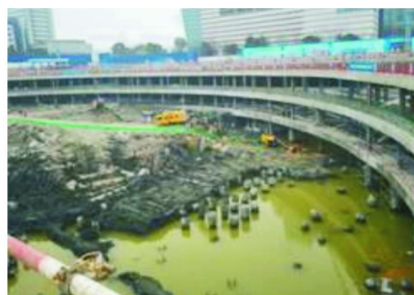
图 1 管涌导致基坑积水
