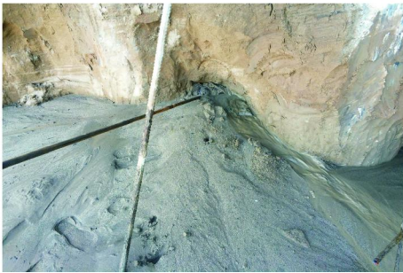
图1 钻孔完后从锚索孔中涌水涌砂
