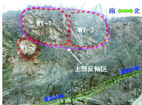
图 3 不倒翁景点附近崩塌地质灾害点危岩体近观图
