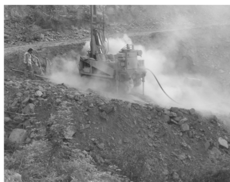
图3 未采取粉尘控制措施钻进照片
