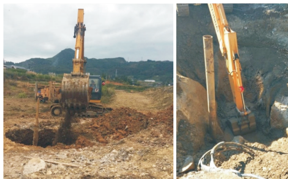
(a) 钻机底部出现塌陷
