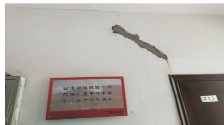
图 1 墙体裂缝照片
