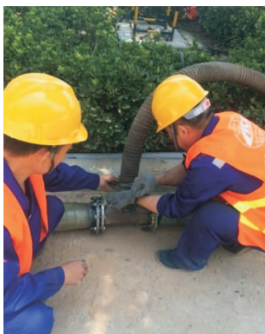
图 7 井口分流 Fig.7 Wellhead diversion
