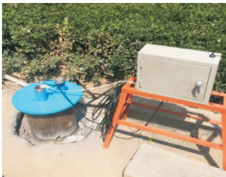
图 9 水位监测 Fig.9 Water level monitoring
