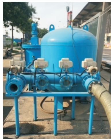
图6 回灌分流器 Fig.6 Recharge shunt
