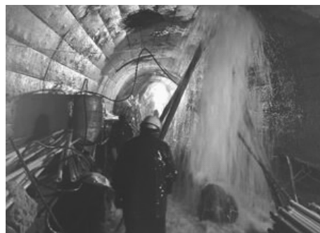
图 1 帷幕钻孔涌水情况
