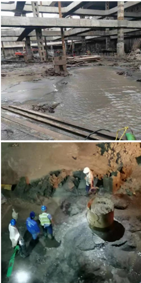
图 1 现场涌水及反压处理情况
