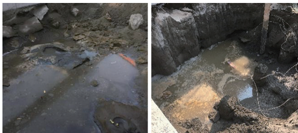
图 3 现场涌水照片
