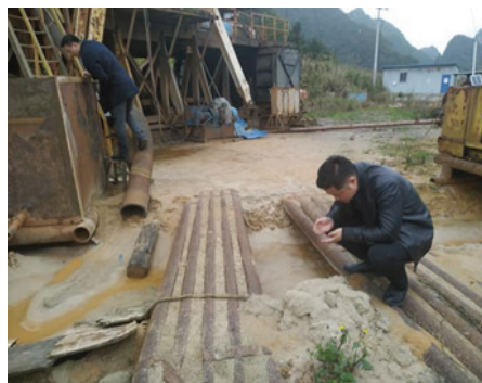
(d) 钻探泥浆未封袋存放造成的污染
