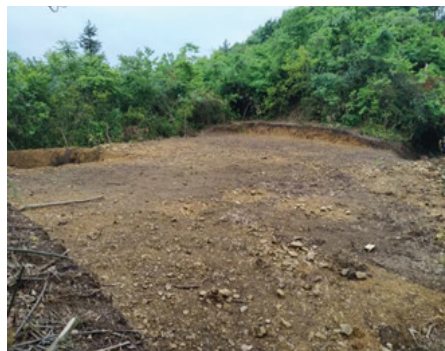
(b) ZK2-5机台平场破坏植被
