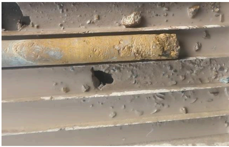
图3 134.4 m漏水部位岩心
