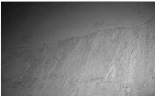
图 8 中隔墙肩部腐蚀、析霜
