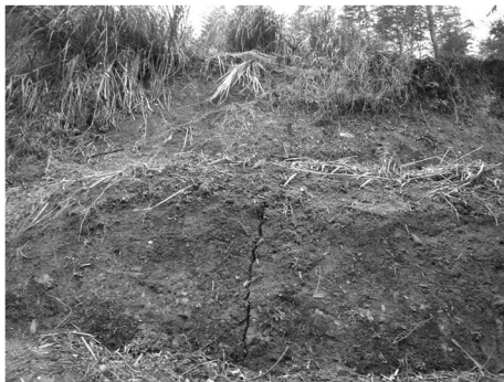
图 4 进洞口地表出现裂缝
