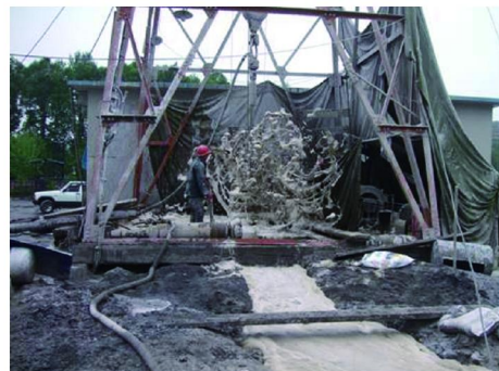
图 4 未安设捕尘装置(泥泞不堪)
