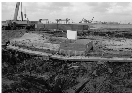
图3 基坑坍塌现场图片
