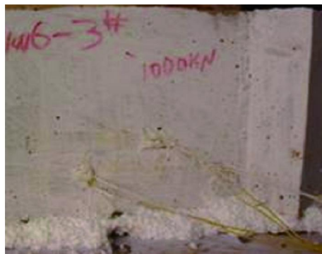
图8 1000 kN(方式一)裂缝
