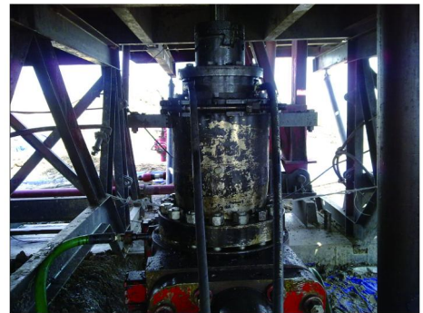
图2 DQX-III型旋转防喷器现场安装图
