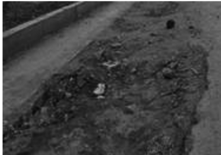
图 1 旧路路基翻浆破坏
