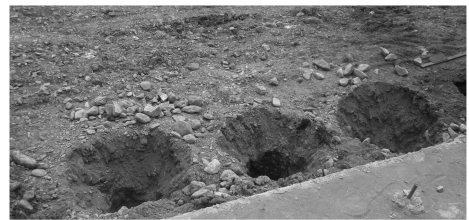
图 2 桩孔坍塌情况
