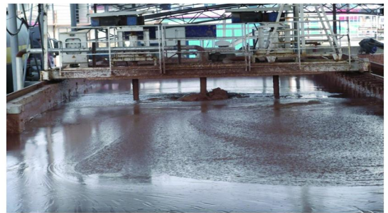
图2 膨润土浓浆制备站
