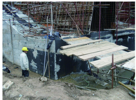
图1 闸基喷水冒砂现场
