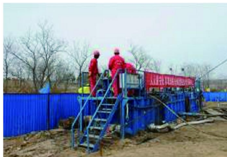
图4 冲洗液固控系统现场
