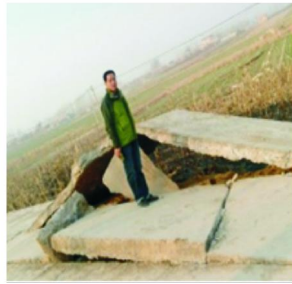
图 3 路面断裂、悬空
