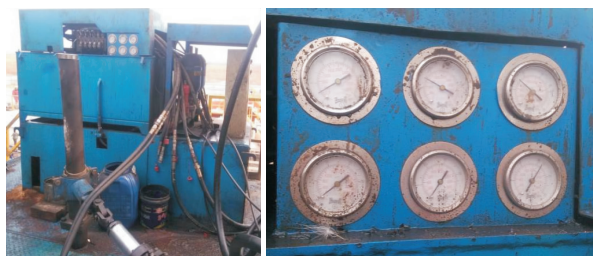
图11 液压站及压力显示
