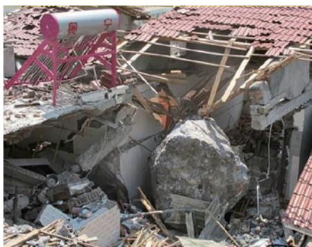
(a) 滚石冲切破坏房屋
