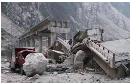
(b) 滚石冲切破坏桥梁
