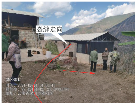
图2 滑坡中部显著变形
