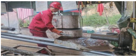
图8 冲洗液回收装置
