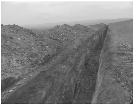
图2 槽探工程对环境的破坏
